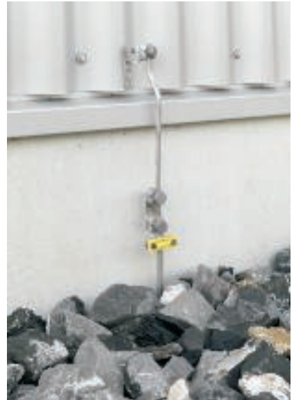
Mérési hely a levezető és a földelő csatlakozásánál
