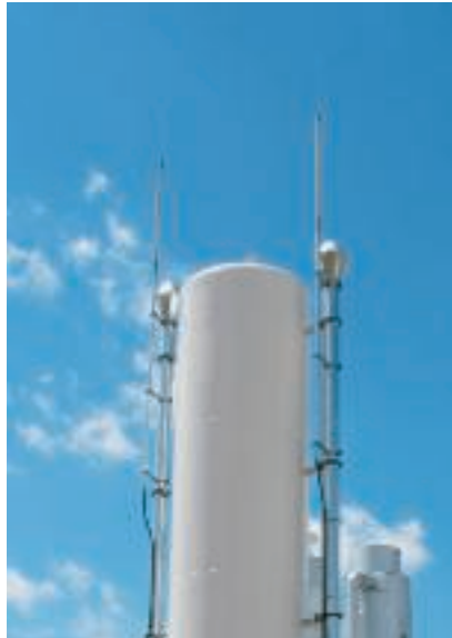
isCon®-rendszer biogáz erőmű kifűvő kéményénél
