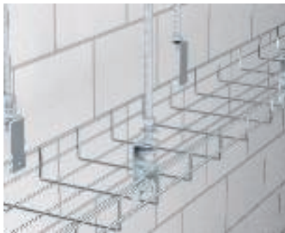
Felfüggesztés oldalfüggesztővel Rácsos kábeltálca felfüggesztése SH M10 típusú oldalfüggesztőkkel és 2078/M10 típusú menetes szárákkal.
